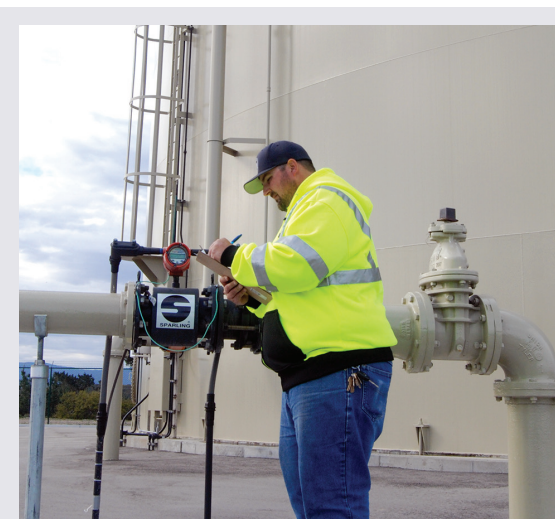
Operador inspeccionando y monitoreando el medidor de flujo en una de las reservas del Distrito
